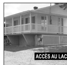
168, DES GRIVES ASBESTOS MLS 18302737
