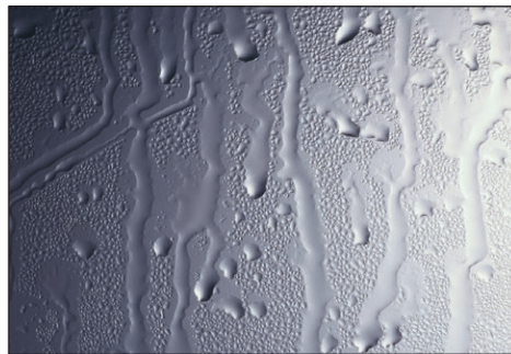
Le surplus d'humidité dans votre maison contribue à l'apparition de moisissures.
